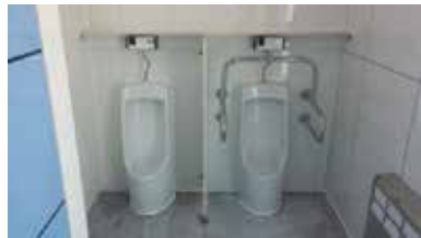
장애인용 소변기 수평-수직 안전손잡이
