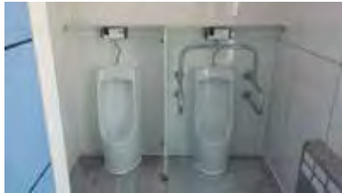
장애인용 소변기 수평-수직 안전손잡이
